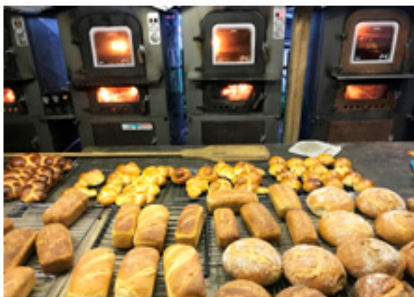
Insgesamt sind fünf Holzbacköfen installiert. Der Holzverbrauch ist beträchtlich. (Foto L. Hänni)
