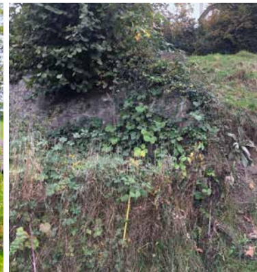
Defekter Abschluss Ostseite.
