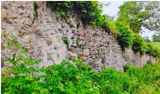
Wurzelwerk zerstörte die Mauerkrone.
