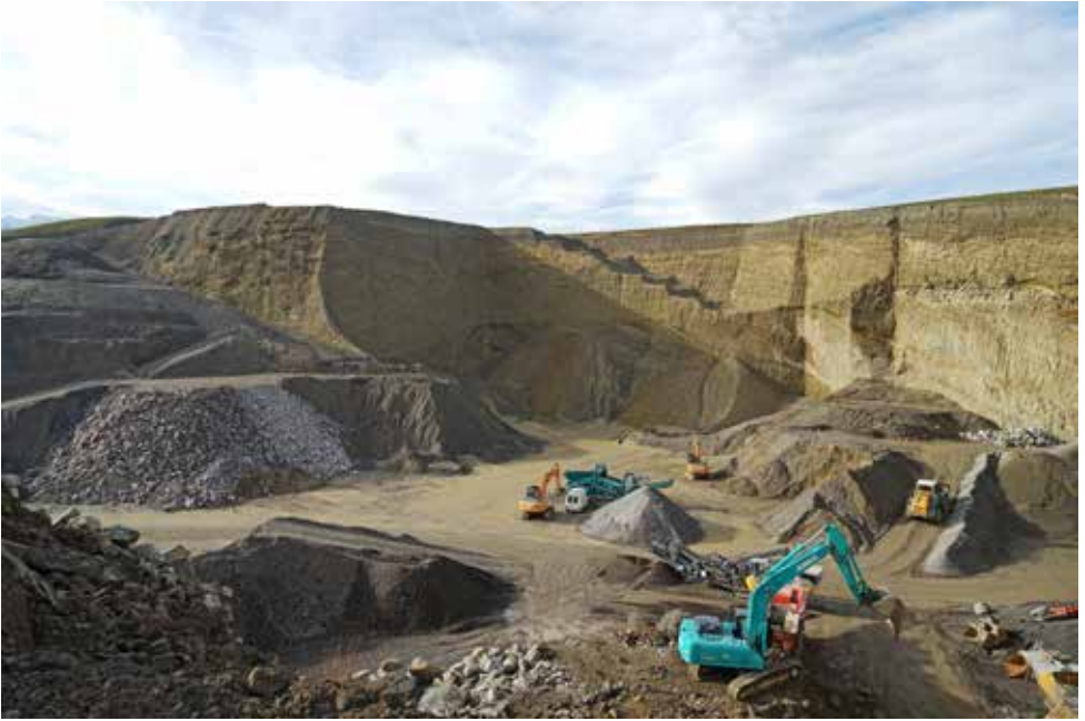
Die Grube mit den auch geologisch interessanten Wänden, welche wertvolle Hinweise zur Erdgeschichte unserer Region geben. Siehe dazu den Beitrag des Autors im See-Spiegel 4/2018. Links im Bild Auffüllung mit Aushubmaterial.
